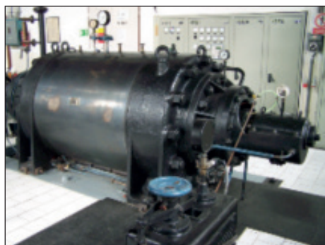
Strojní zařízení elektrárny a generátor jsou ještě v původním stavu
